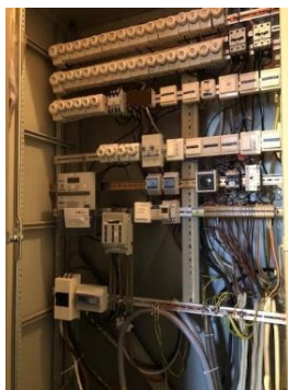
Sikringsskapet i Arnadal kirke
