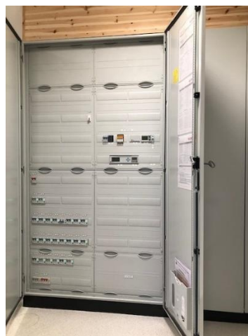
Sikringsskapet i Skjee kirke - oppgradert i 2022
