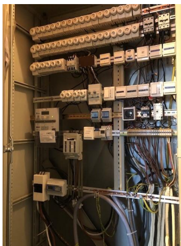
Sikringsskapet i Arnadal kirke - modent for oppgradering
